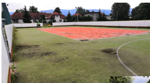
Povrch multifunkčného ihriska pred výmenou povrchu a odvodnením.
