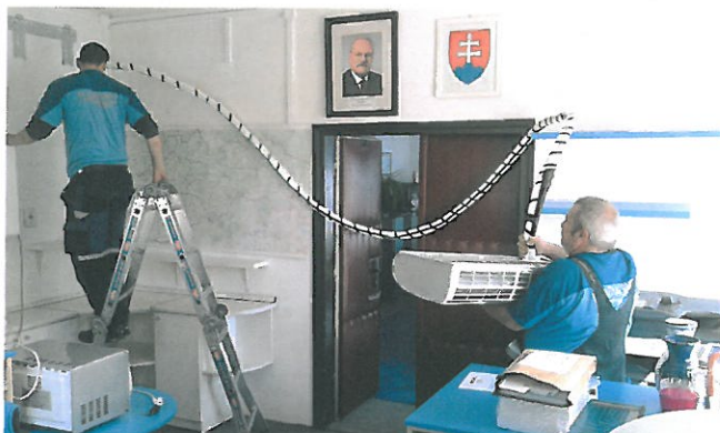
Vybudovanie klimatizácie v budove obecného úradu - slúži nielen na ochladzovanie, ale má aj funkciu vykurovania.
