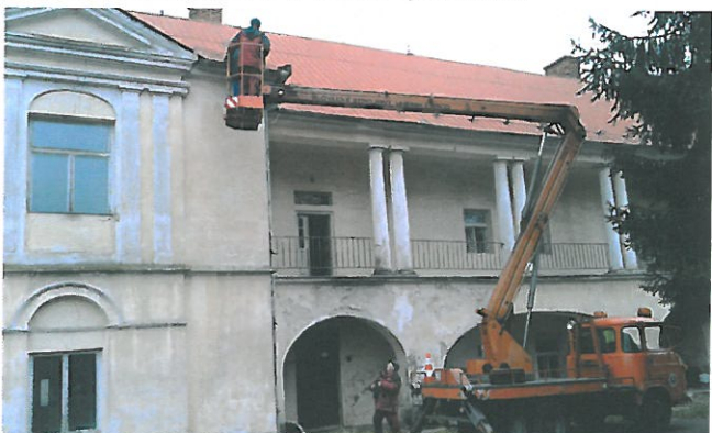
Výmena dažďových zvodov na budove školského kaštieľa. Realizáciou prác zabránime ďalšiemu postupnému znehodnocovaniu kultúrnej pamiatky.
