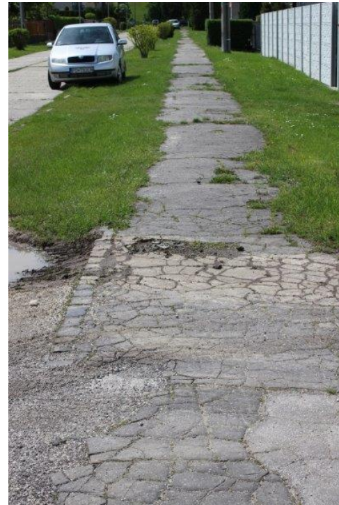
Aktuálny stav chodníka na Žulovskej ulici.
