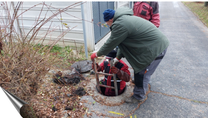
Prečisťovanie kanalizácie na ulici Kpt. Weinholda.
